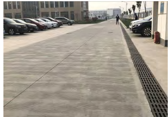
2018年1季度办公楼围墙内绿化排水
