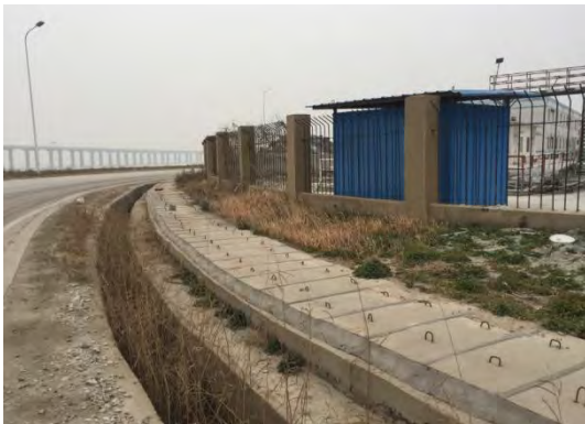
2016年4季度混凝土搅拌站站外排水
