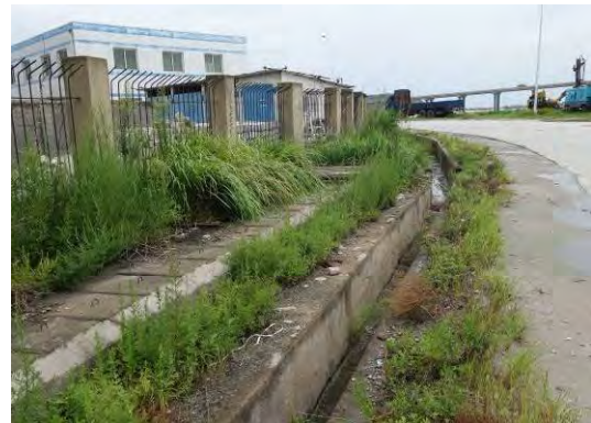
2017年3季度混凝土搅拌站站外排水
