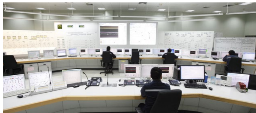
江苏核电 2 号机组主控室全景
